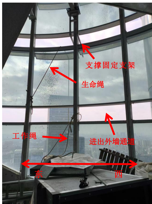
图5 广商中心项目第34层南侧的铝合金玻璃幕墙（专家勘查现状）
